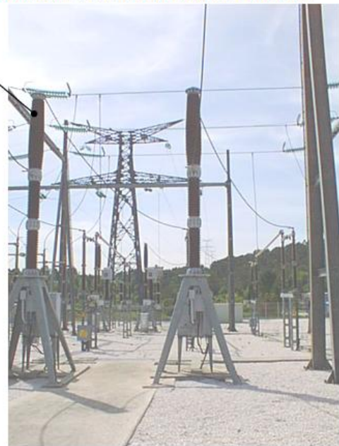
Disjoncteur 63 kV au SF6
