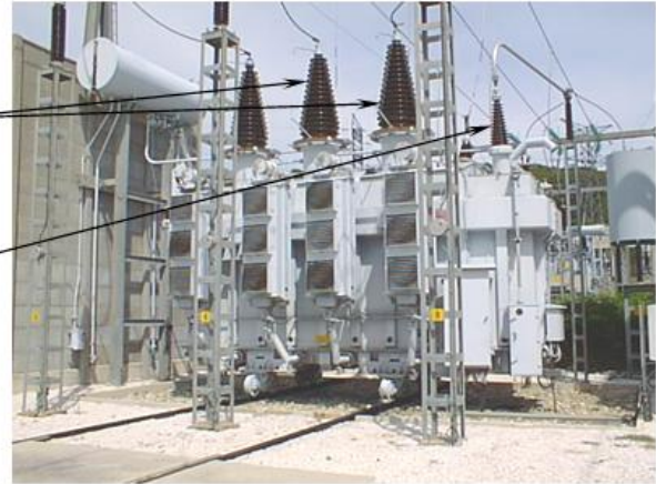
Transformateur 225/63 kV immergé dans l'huile
